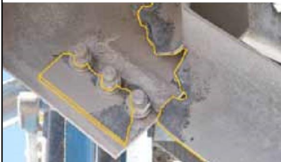
Falla de conexión por arrancamiento del bloque de corte
