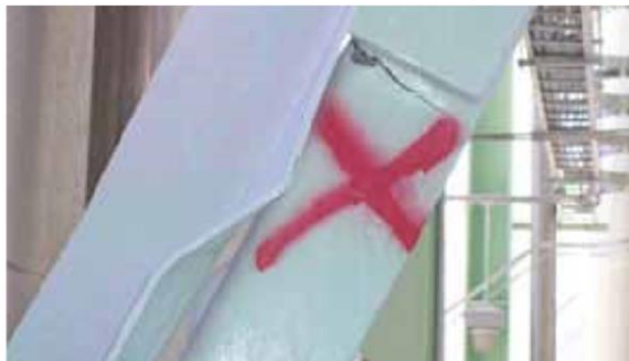
Pandeo local del ala de diagonal XL y fractura en conexión ala del ángulo con planchuela separadora
